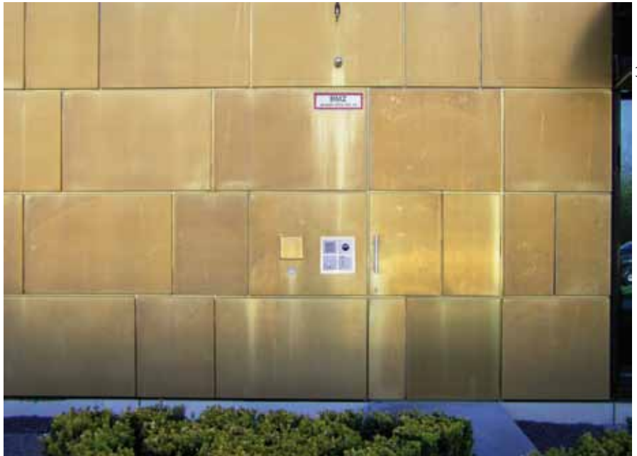
Ursprünglich goldfarbene Messingfassade nach 3 Jahren Bewitterung mit Ablaufspuren und Farbveränderungen.
