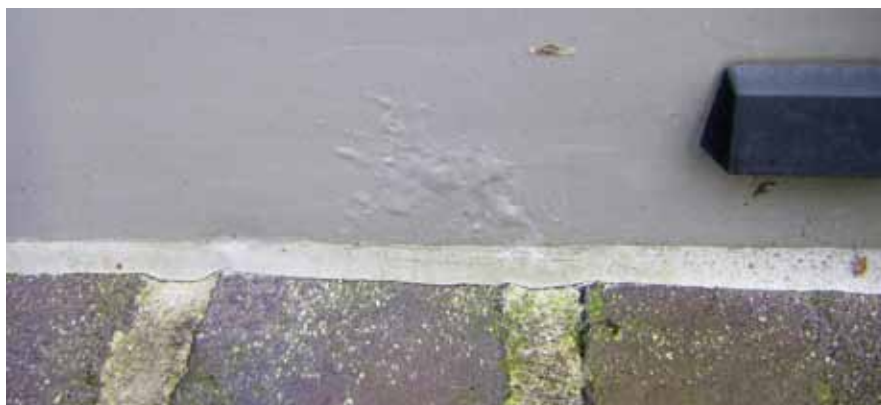
Filiformkorrosion – ausgelöst durch Chlorideinwirkung.
