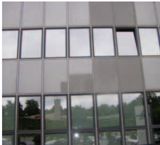
Bild 3: Verwendung abrasiver Reinigungsmittel bei einer Metallic-beschichteten Fassade.
