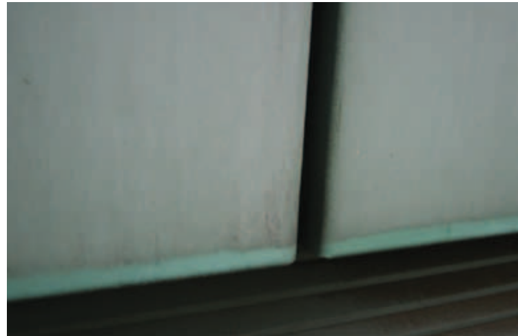
Bild 4: Blau metallic beschichtete Aluminiumteile. Die Unterkante zeigt bedingt durch die Schmutzabdeckung noch weitgehend den Originalfarbton. Die restliche Fläche ist bereits stark verwittert.
