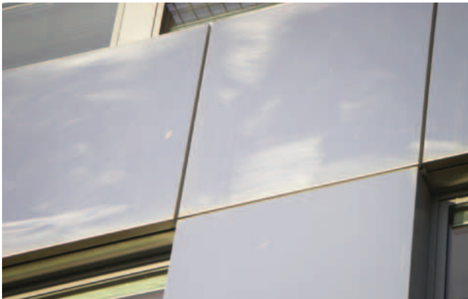
Bild 5: Edelstahlfassade mit Kratzspuren von einer Reinigung herrührend.
