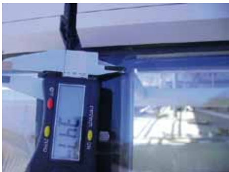
Bild 3+4: Visuelle Unregelmäßigkeiten von Isoliergläsern am Randverbund / Verklebung.
