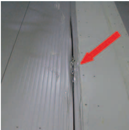
Bild 8: Durch die Eisbildung werden die Paneelfugen auseinandergedrückt und beschädigt.
