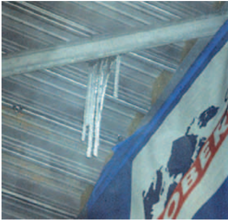
Bild 6: Eiszapfen, die sich im Dachbereich bilden.
