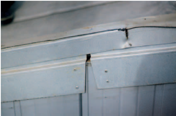
Bild 10: Leckagestellen in der Attika.
