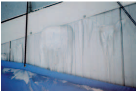
Bild 7: Flächige Vereisung im Wandbereich.
