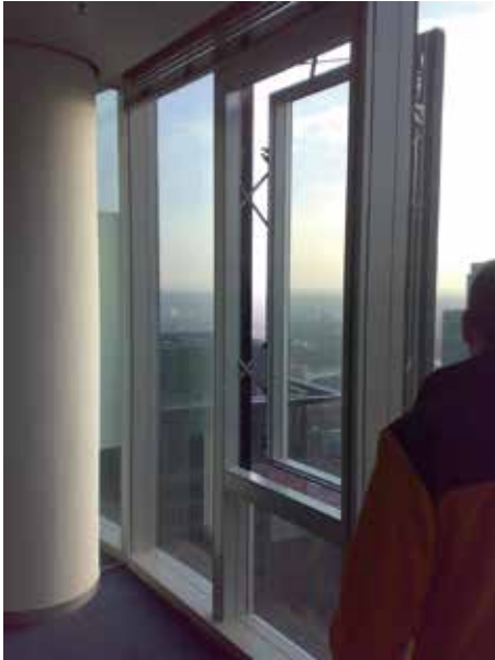
Parallelausstellfenster [PAF] geöffnet, Innenansicht
