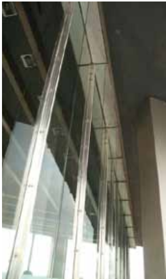
Glasbrüche an den statisch relevanten Glasschwertern.
