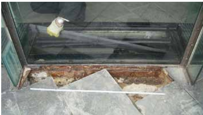
Korrosion am Fassadensockel.
