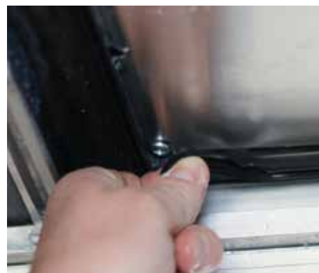
Detail-Untersuchung des Konstruktions-Inneren nach dem Wasser-Test.
