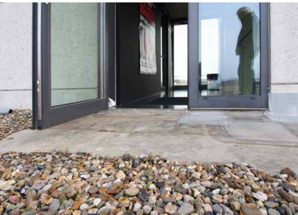
Außentür ohne Rinne und ohne weitere Schutzmaßnahmen – so bitte nicht!
