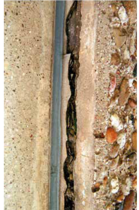
Bild 7: Abriss der Betonflanke neben einer elastisch abgedichteten zu schmalen Bewegungsfuge (Überbeanspruchung der Fugenflanke).
