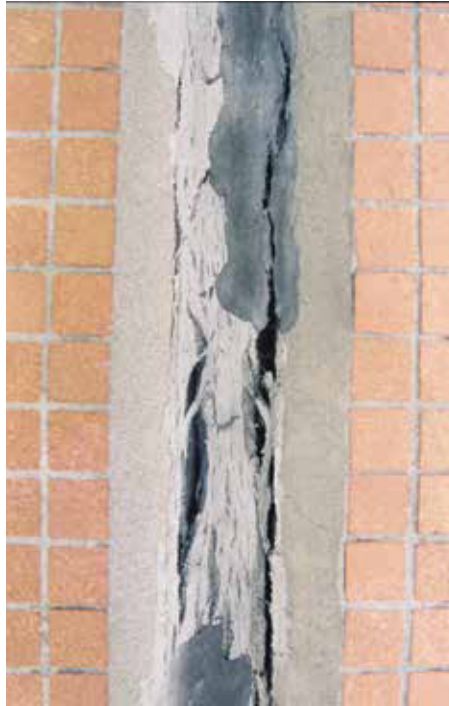
Bild 6: Gerissene, nicht ausreichend elastische Dichtstofffuge – bereichsweise erfolglos nachgearbeitet (Überbeanspruchung des Dichtstoffes).
