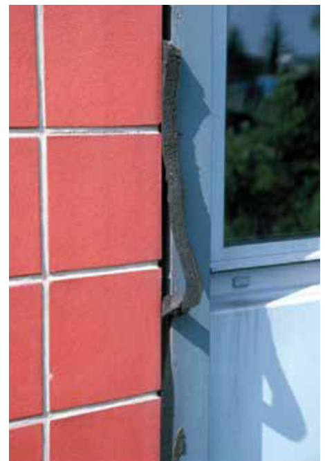
Bild 9: Leicht aus der Fuge herausziehendes, unzureichend komprimiertes Dichtungsband
